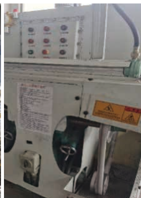
抛光打磨机及喷涂线 升级完善氢气警报系 统、水量水位计等安 全装置
