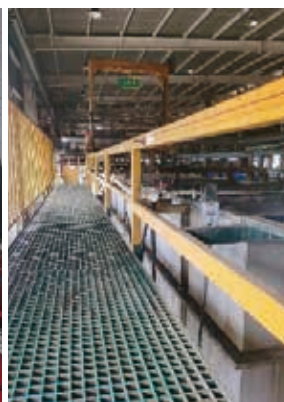
应急拉线开关，电源能 适时关闭，确保长距离 生产线设备安全运行
