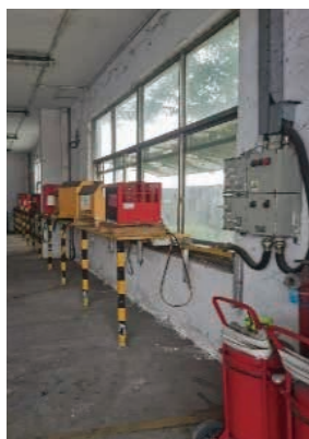
叉车充电区专项治理— 独立房间隔离、 消防应急措施配置
